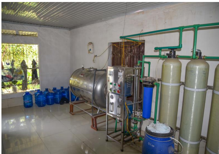
Deel van de waterfiltratie installatie met containers
